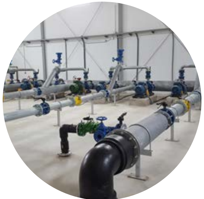
Bombeo del cabezal de riego de la Comunidad de Regantes Foia del Pou
